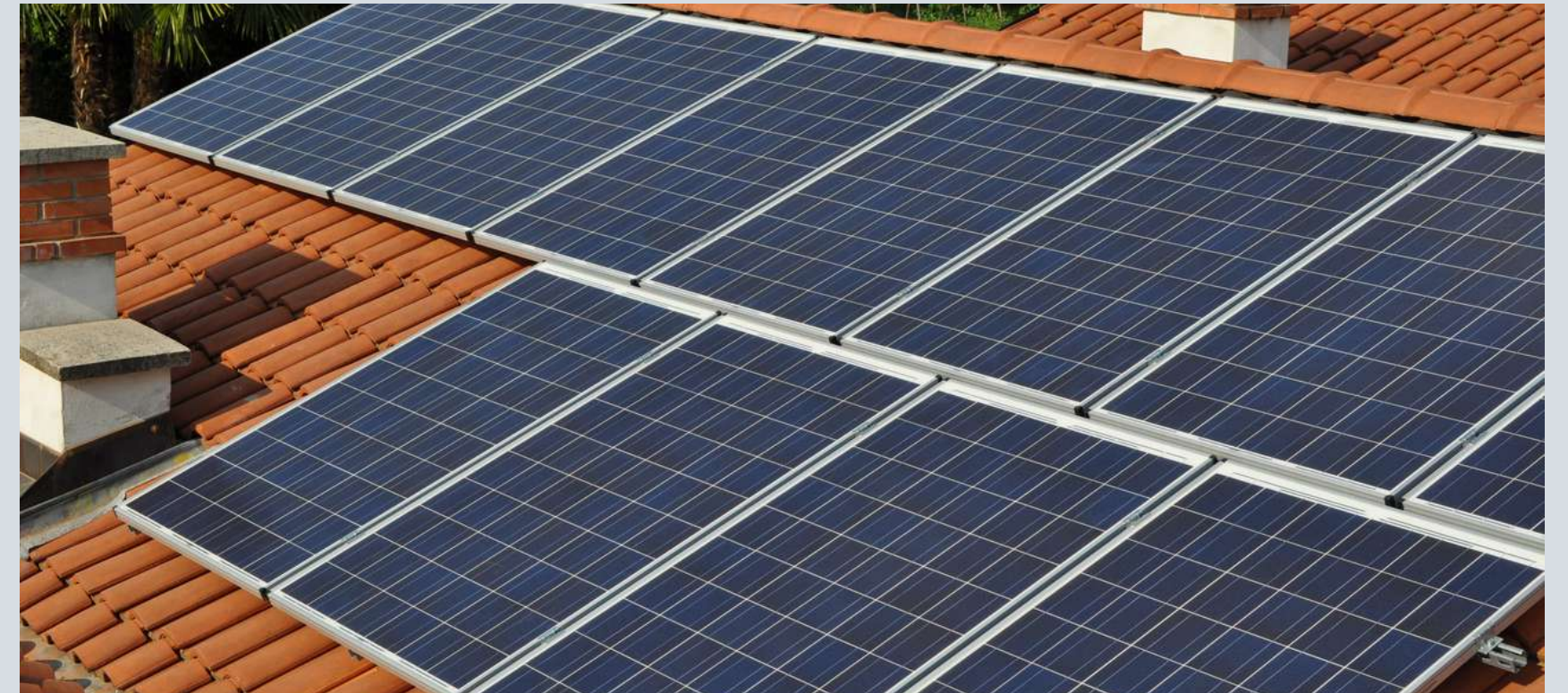
Impianto residenziale da 3,76 kW (TN)
