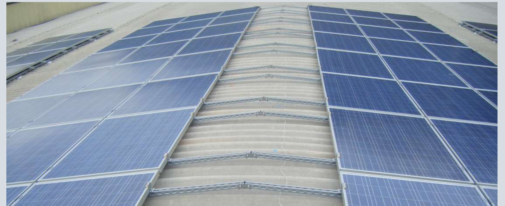
Impianto da 60 kW su copertura a doppia campata (TN)
