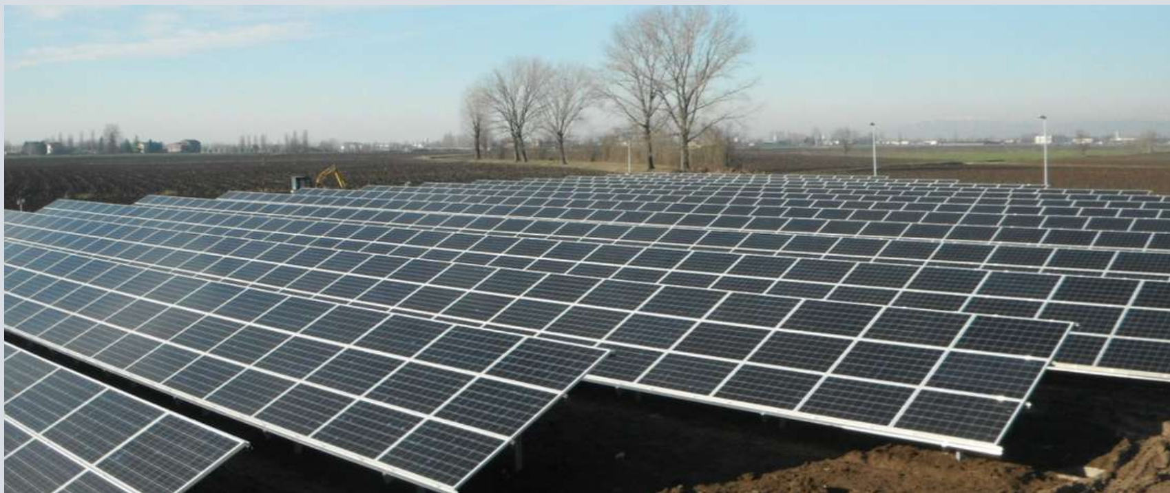
Impianto da 700 kW terra per un'azienda agricola (PD)
